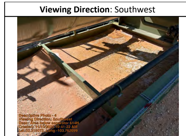
Area below separator 614H
