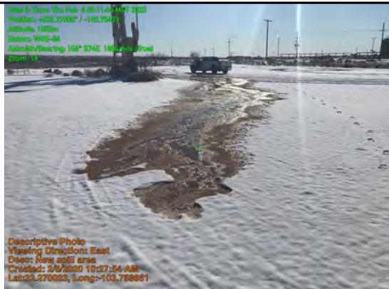
New spill area
