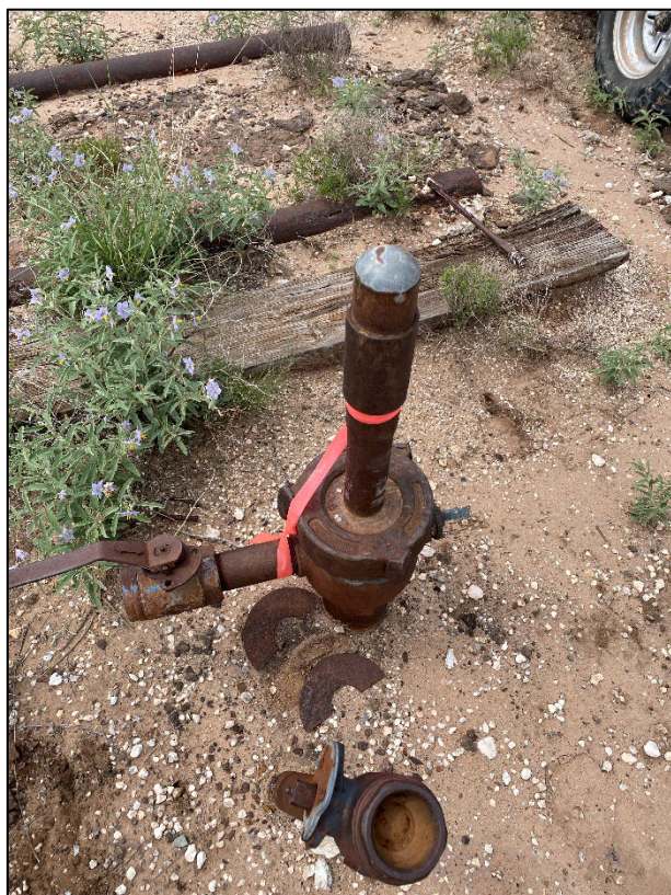
3) Twin Lakes SA #066 (30-005-60468) – Wellhead
